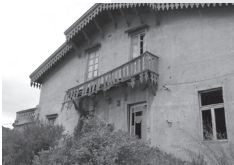
Imatge del procés d'extracció dels grafitis, i vista general de l'estat actual de l'antiga fàbrica Rosselló, a Mascanada. Foto: MHSFG.
